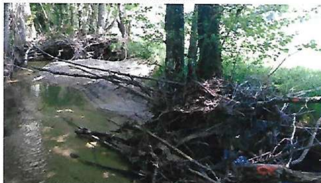
Photo du Mousse avant travaux
